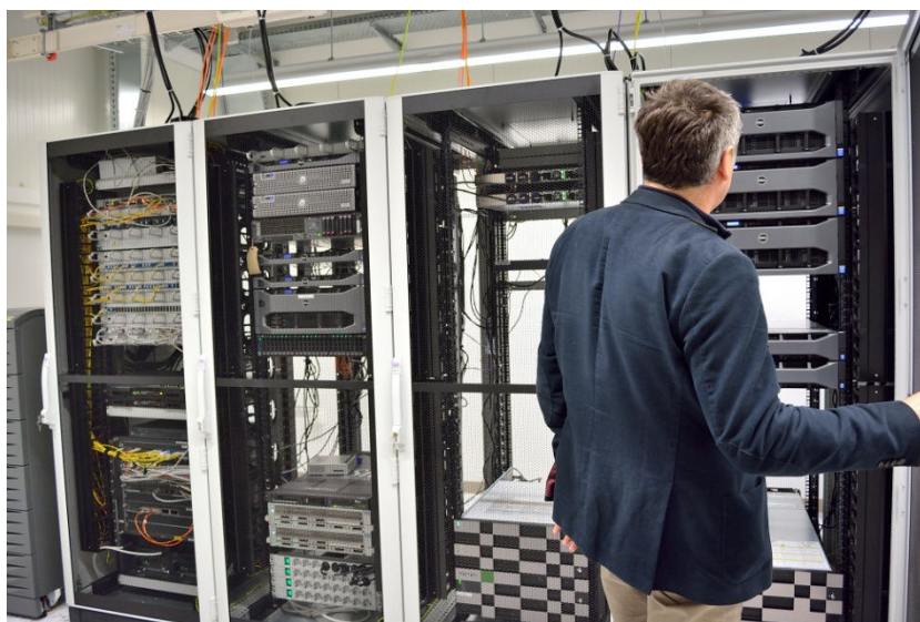
Poslužitelji i komunikacijska oprema u novom podatkovnom centru DC Srce2
